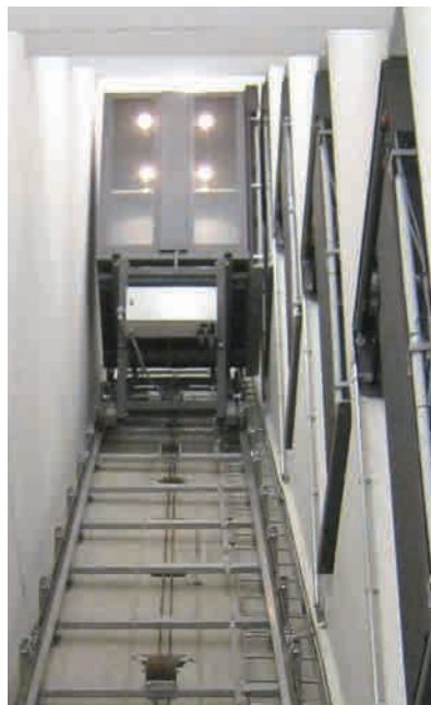
INTRA-Anlage in Richterswil
