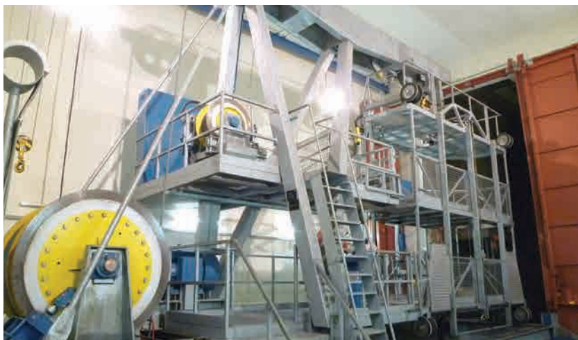
Die Aufzugsanlage für Wartungsarbeiten in den Lüftungskaminen
