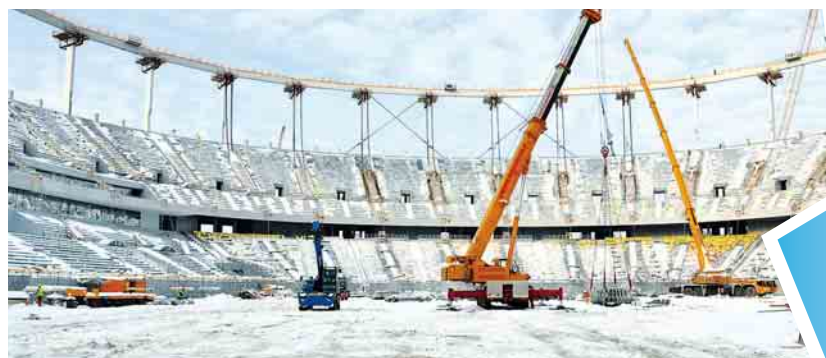
Dachaufzug bei eisigen Temperaturen in Bukarest.
